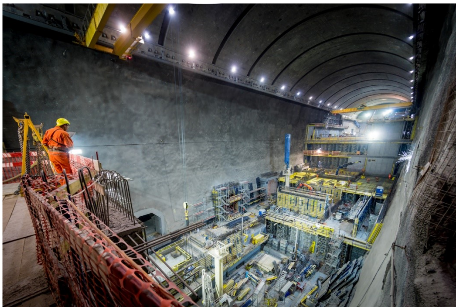
Obrázek č. 11 – Výstavba vodní přečerpávací elektrárna v Nant de Drance. Zdroj: www.alpiq.com
