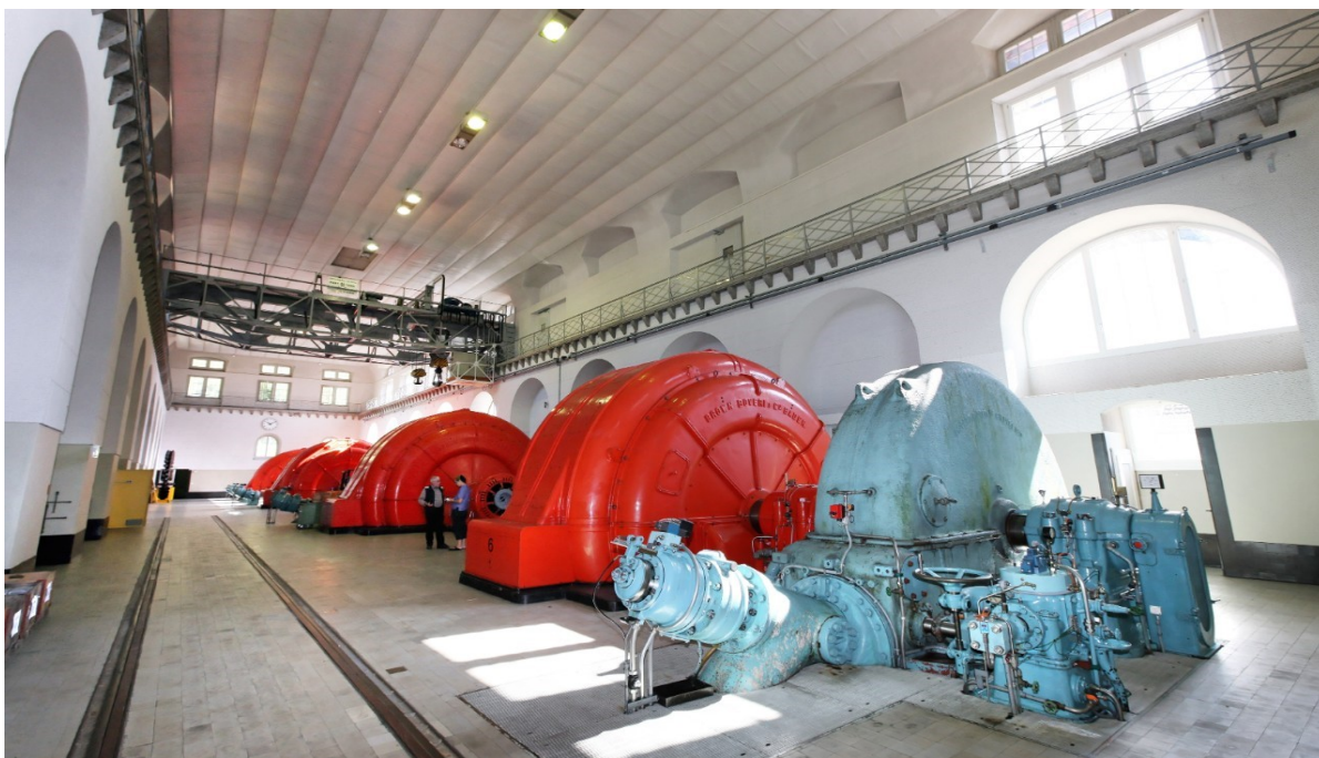
Obrázek č. 10: Provozní hala elektrárny Ritom. Zdroj: [8]
