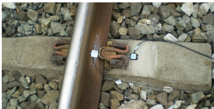
Obr. 5 Osazení kolejnice a pražce snímači zrychlení – upevnění Pandrol FC
